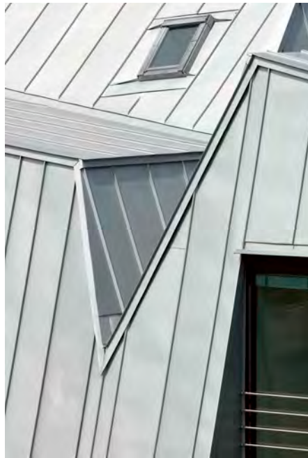
Detail an einem der Einschnitte, die mit doppelter Rinnenausbildung und einer Rinnenheizung ein dreistufiges Sicherheitskonzept erhielten.
