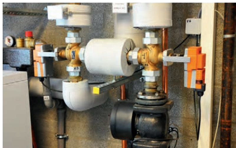
Abb. 3: Der Kesselkreis läuft über zwei Umschaltventile (mit orangefarbenen Stellmotoren).
