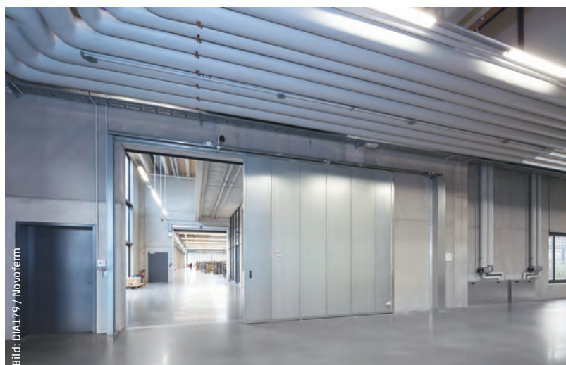
Abb. 3: Einflügeliges Feuerschutzschiebetor mit Feststellanlage und elektrischer Öffnungshilfe als großflächige Brandabschnittstrennung.
