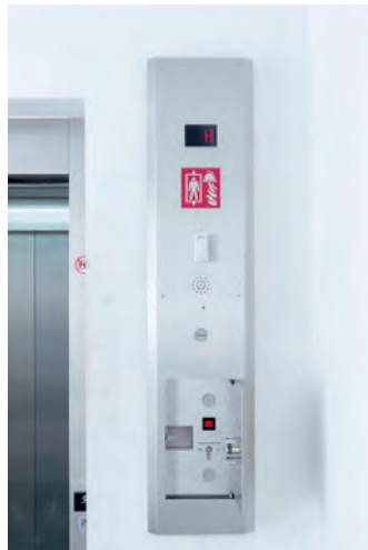
Steuerungstableau eines Feuerwehraufzugs mit dem entsprechenden Piktogramm
