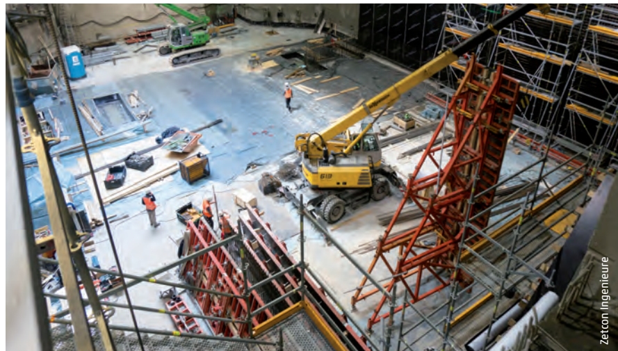
Sieben neue Haltestellen sollen bei dem Karlsruher Jahrhundertprojekt entstehen. Der Bau des ersten Teilprojekts der Kombilösung Karlsruhe soll 2018 abgeschlossen sein.
