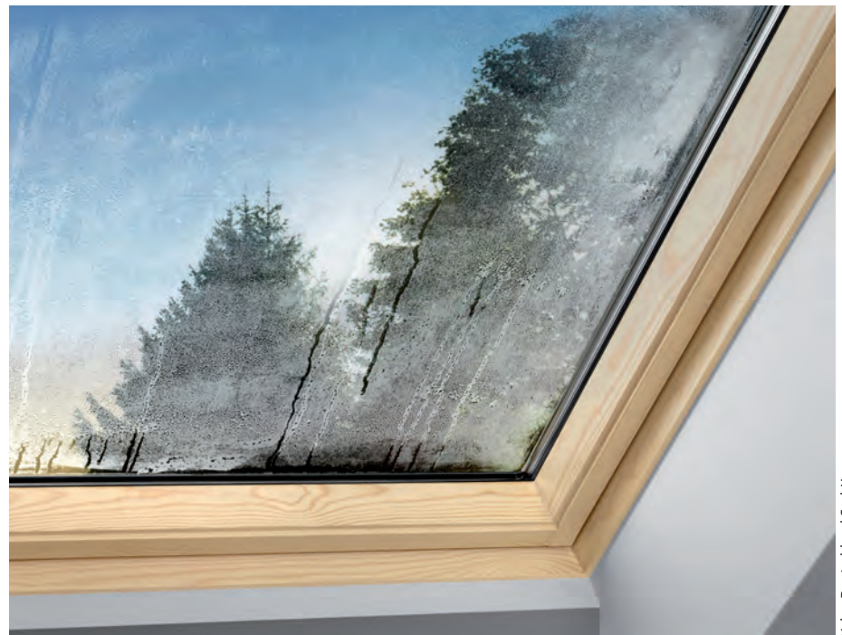
Durch unzureichendes Lüften in Kombination mit einer dichten Gebäudehülle kann die Luftfeuchtigkeit nicht mehr entweichen, sodass es zu Kondensatbildung am Fenster kommen kann.
