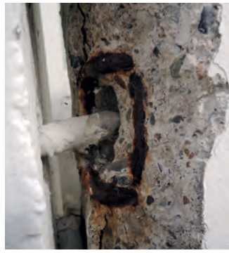
Korrosion im Bereich der Bewehrung der Horizontalverankerung. Hier war eine zusätzliche Bewehrung statisch erforderlich, die in die Platte eingebunden wurde.
