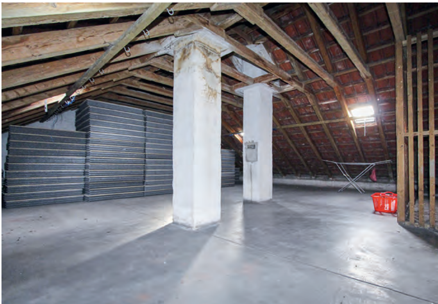
Der Dachboden in der Sonnenhalde in Ulm vor dem Verlegen der Dachbodendämmplatten
