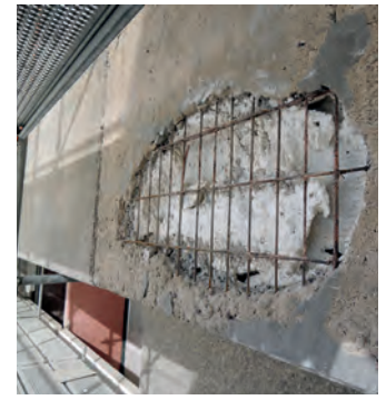
Freigelegte Schadstelle im Bereich der glatten Stahlbetonelemente. Wetterschutzschalen und Brüstungsplatten der Loggien erhalten abschließend ein Oberflächenschutzsystem Typ OS 4.
