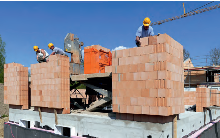
3 Die perlitgefüllten Poroton-Ziegel T7 in einer Wandstärke von 49 cm sind die Basis der hoch wärmedämmenden und zugleich Wärme speichernden Gebäudehülle des Effizienzhauses Plus. Der Ziegel verfügt über einen Wärmeleitwert von 0,07 W/(mK) und erreicht bei der ausgeführten Wandstärke einen U-Wert von 0,14 W/(m 2 K).
