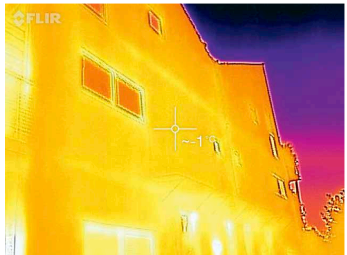
Abb. 2: Temperaturdifferenzen Mauerwerk/Beton am Nordgiebel
