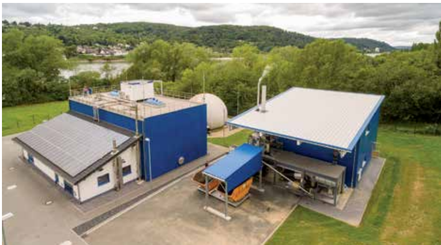
Kläranlage Linz-Unkel, Quelle: Dr. Siekmann + Partner mbH
