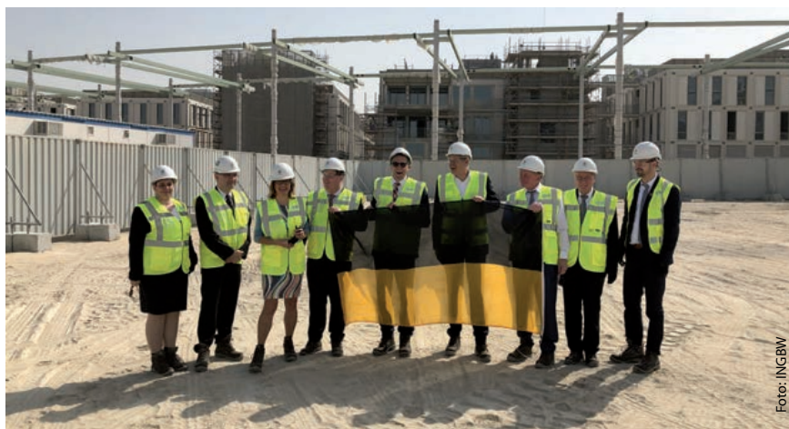
Besuch des Grundstücks für das Baden-Württemberg Haus auf dem Expo-Gelände in Dubai - von links: Claudia Martin MdL, Dr. Stefan Fulst-Blei MdL, Staatssekretärin Katrin Schütz, INGBW-Hauptgeschäftsführer Daniel Sander, bw-i Geschäftsführer Dr. Kai Schmidt-Eisenlohr, FWTM-Geschäftsführer Daniel Strowitzki, Director Innovation and Globalization an der Steinbeis University Claus Schmiedel, INGBW-Vorstandsmitglied Dr. Andreas Hutarew, FTWM-Projektleiter Moritz Schreder
