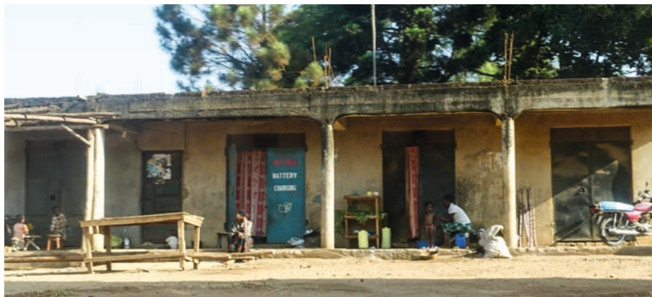
Das Gesundheitszentrum in Kako ist in ähnlich schlechtem Zustand wie das Gebäude oben.
