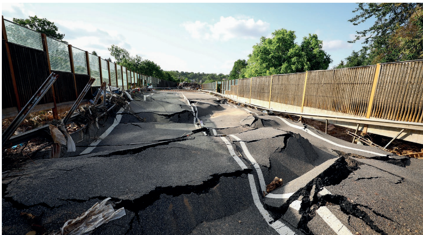
Eine zerstörte Straße in Euskirchen—Aufnahme vom 18. Juli 2021.
