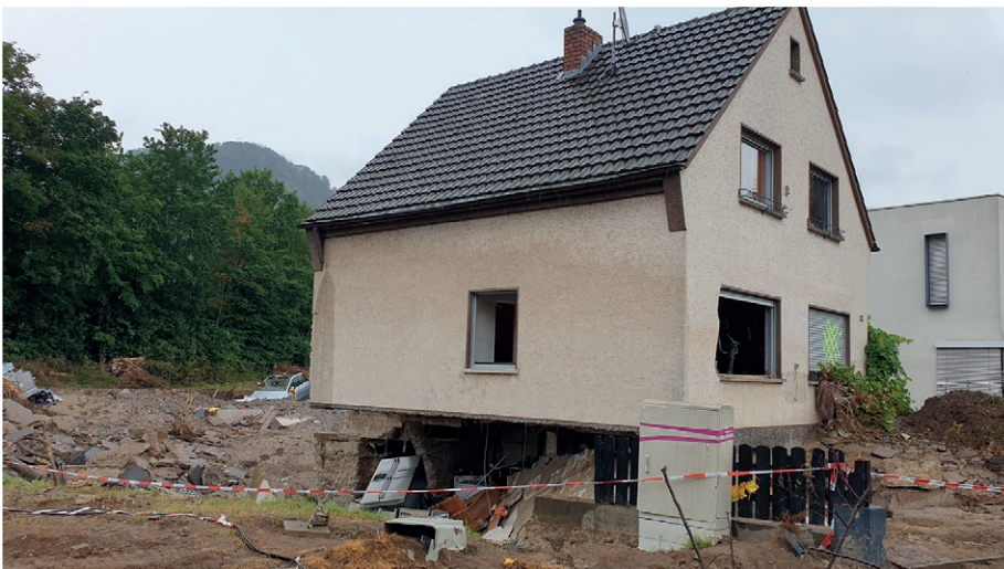
Haus in Heimersheim ohne tragende Wände im Kellergeschoss, aber ohne sichtbare Risse
