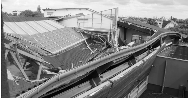
Blick auf die eingestürzte Dachfläche des Sportbades im „Aquarium“ Schwedt/Oder | Foto: Dr. Lutz Lehmann | BBIK
