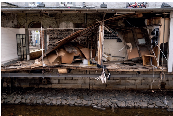
Ein Friseursalon in Stolberg ist durch das Unwetter komplett zerstört worden.
