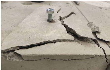
So soll es nicht sein: Risse in der Bausubstanz
