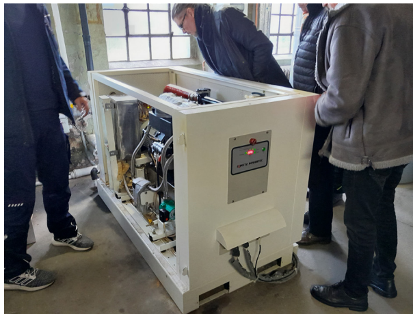
Mini-Kraftwerk bei ÖTEC © Dipl.-Ing.- Bernd Pachheiser
