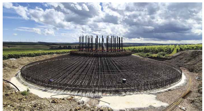
Das Stahlbetonfundament mit 24 m Durchmesser und einem Volumen von 850 m 3 bei einer Höhe von 2,8 m, hergestellt aus Ortbeton der Güteklassen C40/50 und C30/37.
