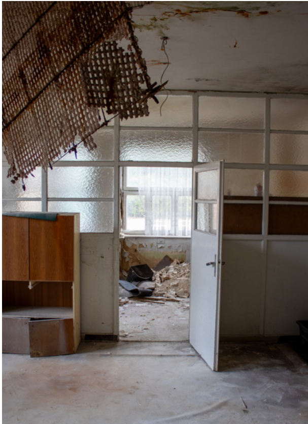
Über 80 Personen wollten am Tag der Baukultur einen Blick in den 30 Jahre verlassen Ort werfen. Darunter auch einige, die in der alten Brennerei gearbeitet haben. | © BBIK
